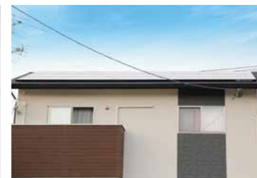
屋根一面に乗せたソーラーパネル。陽当たりも良く、天気の良い日は発電量も満足いくものだそう。
