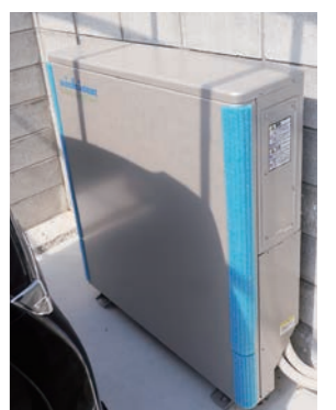
蓄電池は駐車スペースに設置。お車を守るために、青いカバーをつけて方が一の衝突にも備えています。
